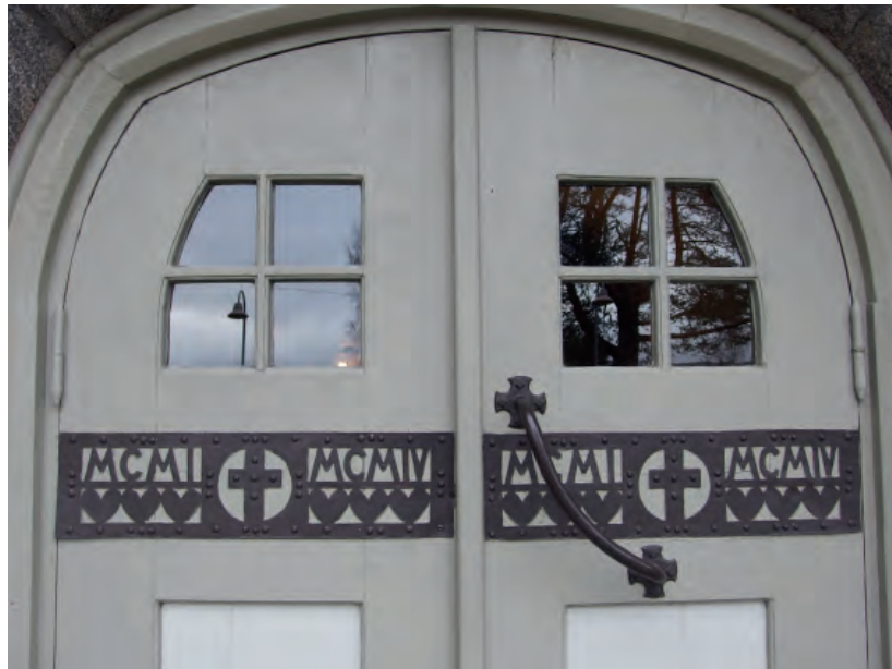
Kirkon ovia ja ikkunoita vuonna 2015 tehdyn korjauksen jäljiltä.
