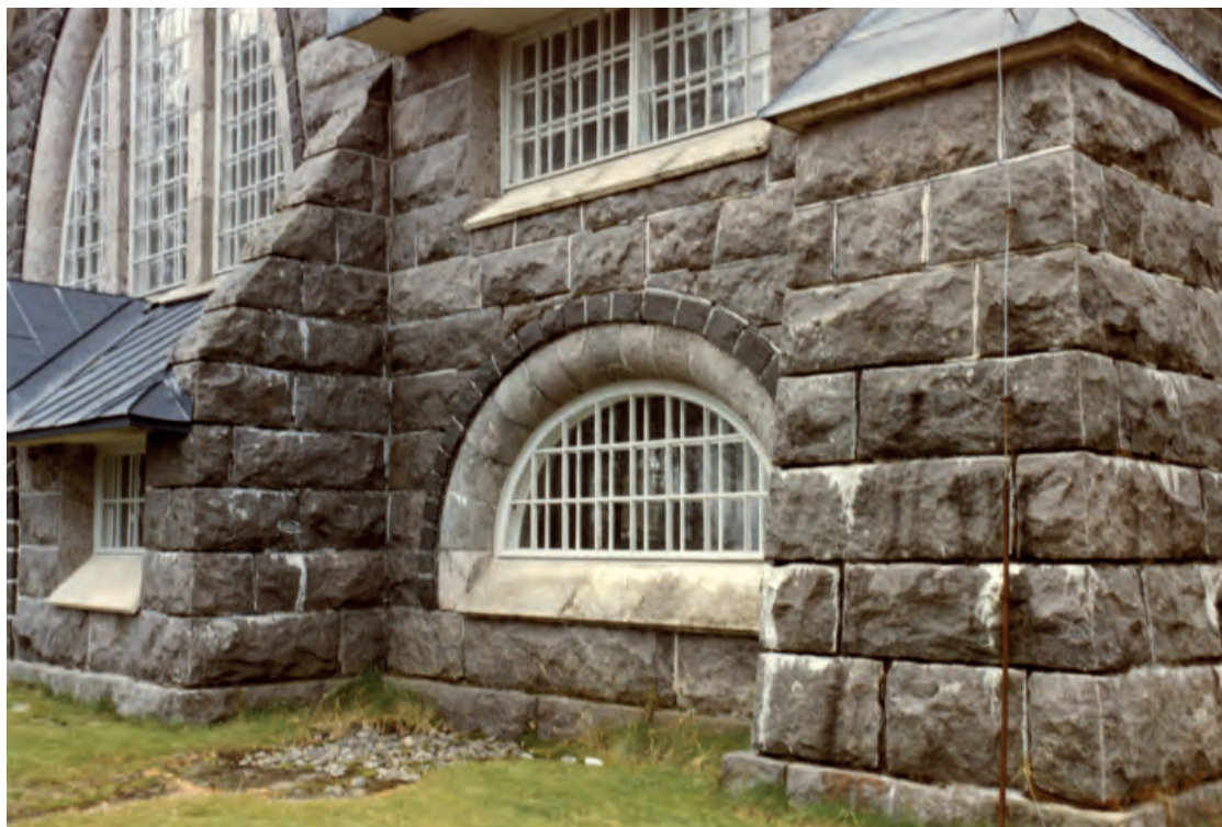
Kirkon ulkoseinämuureihin oli päässyt imeytymään kosteutta sekä seinäkivien saumausten rikkoutumisen että kirkon sokkeleista muuriin nousevan kosteuden takia.
