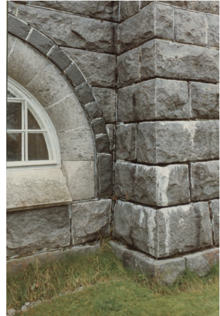
Ulkoseinämuurausten saumat olivat ennen 1990-luvun alussa tehty saumausten korjaamista erittäin huonossa kunnossa varsinkin viistojen kivipintojen kohdalla.
