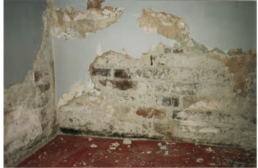
Ulkoseinän alaosaa kohdassa, jossa vesi oli sokkelin päältä päässyt imeytymään muuriin. Ilmiötä lisäsi se, että sokkelit on vedetty lähes 10 cm ulkoseinälinjaa ulommas.
